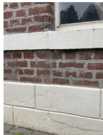
scheurvorming in gevel
