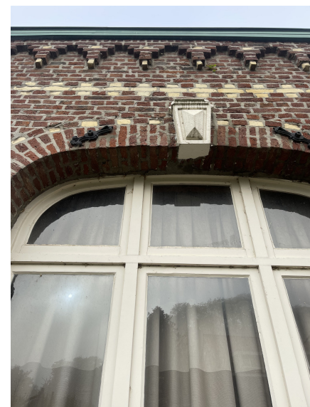
hoeken sluitsteen afgebroken
