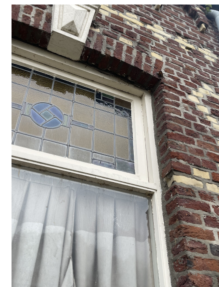
kozijn met glas in lood en enkel glas
