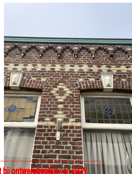
Behoort bij ontwerpbesluit van 19-12-2021 scheurvorming metselwerk boven kozijn d.d. 06-12-2023
