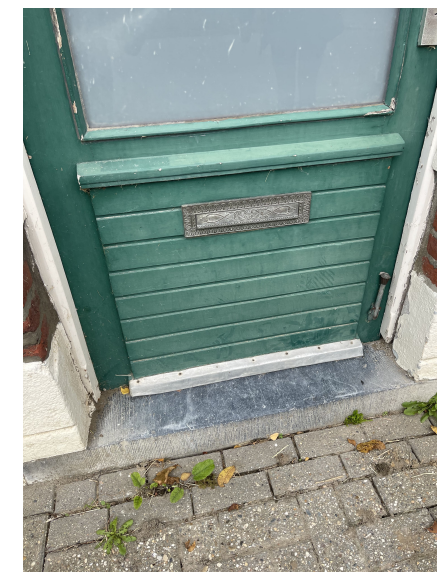
deur en kozijn verkeren in slechte staat
