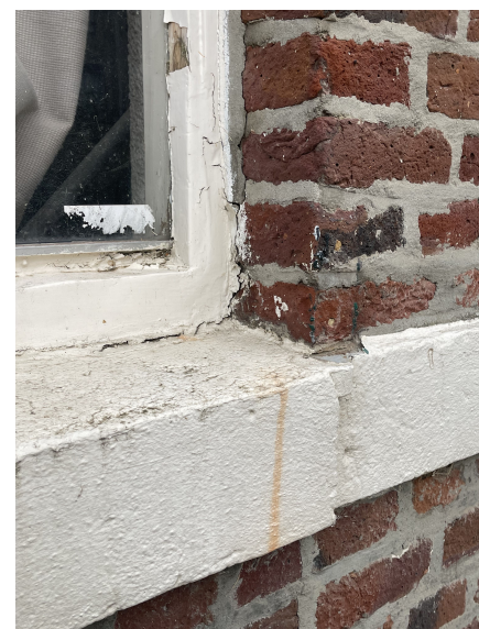
kozijn verkeerd in slechte staat
