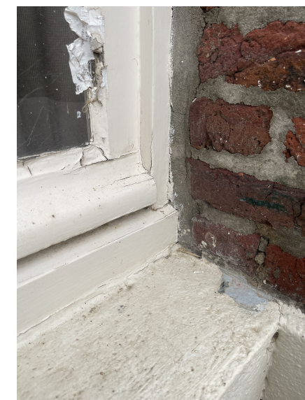
kozijn verkeerd in slechte staat
