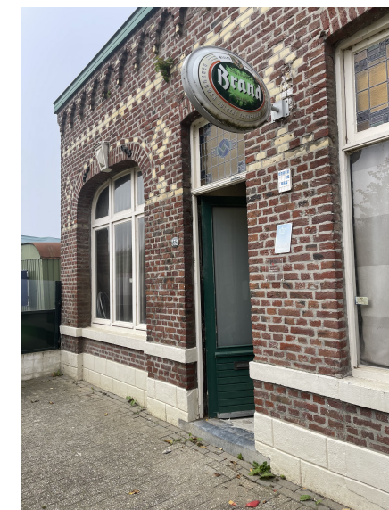
kapot metselwerk achter reclamebord
